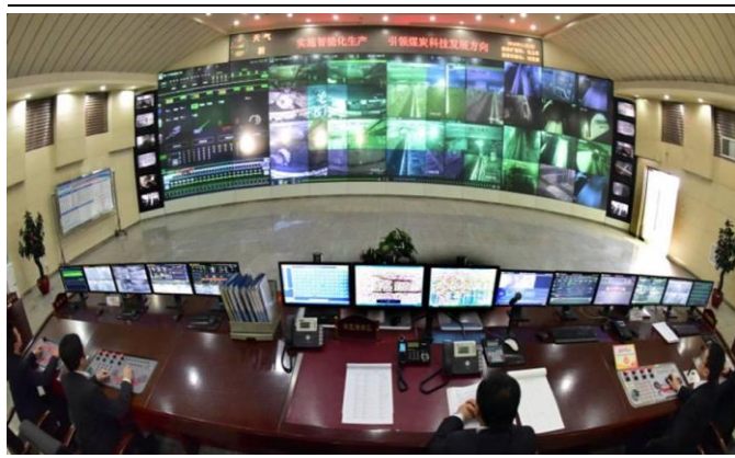
图2：黄陵煤矿智能化工作面指挥调度中心全景
