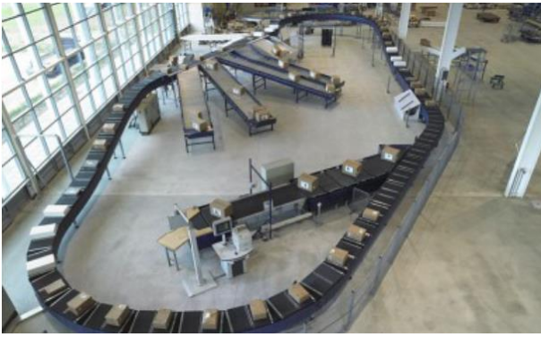
图 21 码垛分拣设备-交叉带式分拣系统
