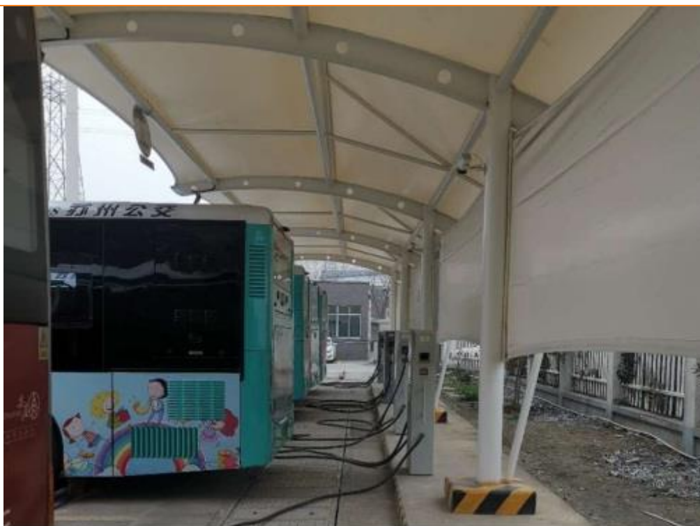
图 21：南瑞充电桩应用实景
