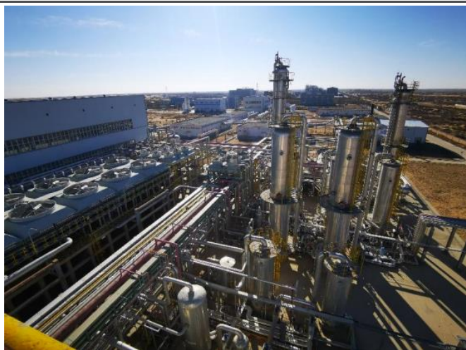
图34：森泰能源的LNG液化工厂
