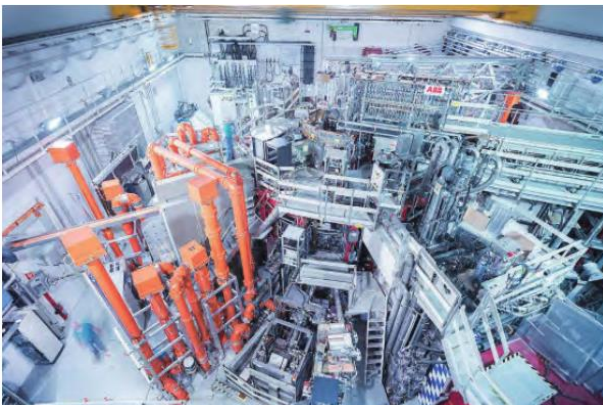
图表 22 德国 ASDEX Upgrade 装置主机大厅
