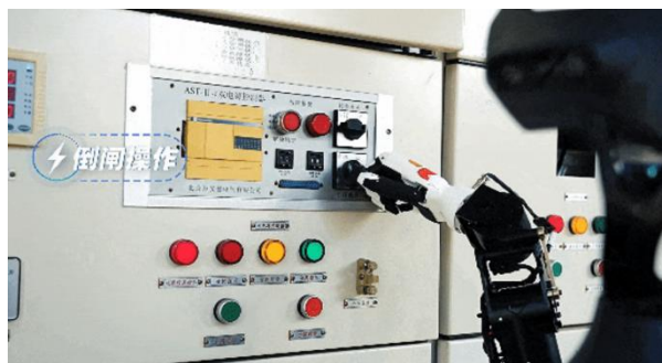
图100: 天工完成精准倒闸工作
