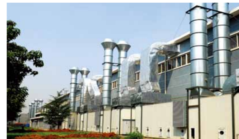
中国北车唐山客车公司钢结构厂安装整体除尘系统，烟气排放100%达标
