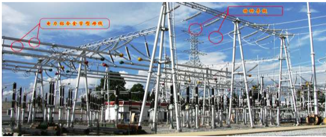
图：公司铝合金管母线云南德宏 500kV 变电站投运现场
