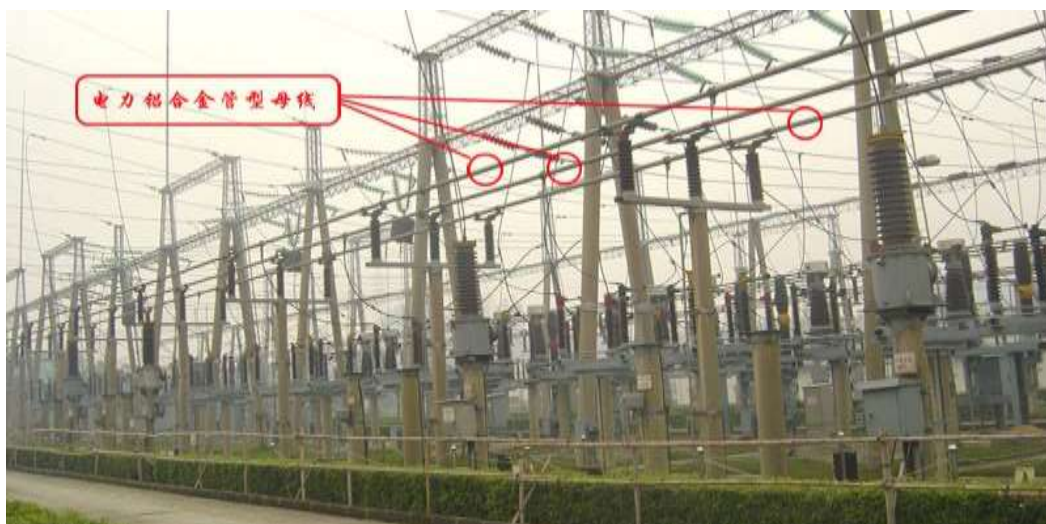
图：公司铝合金管母南方电网 500kV 广南变电站投运现场
