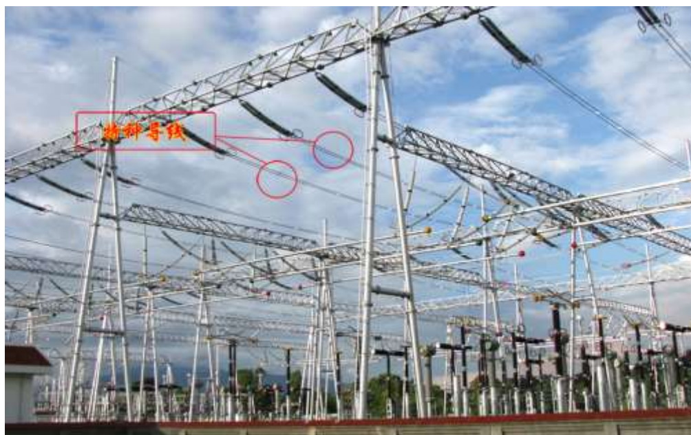
图：云南德宏 500kV 变电站投运现场
