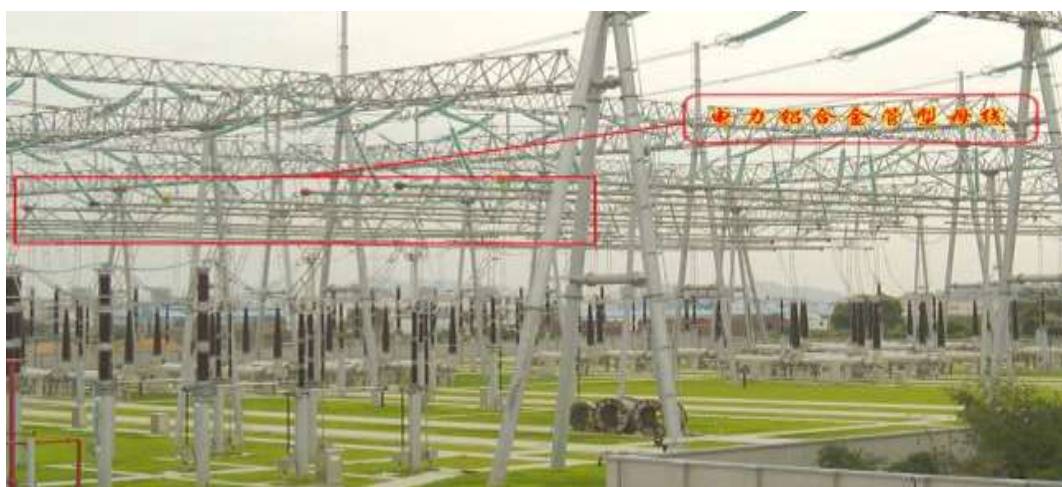
图：公司铝合金管母三峡工程龙泉 500kV 换流站投运现场
