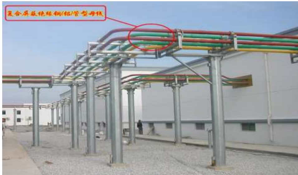
图：公司复合屏蔽绝缘管母产品江苏徐州扬台 220kV 变电站投运现场
