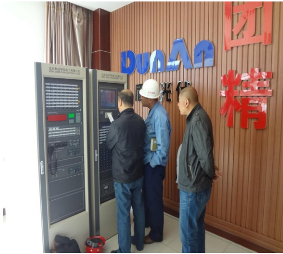
光伏消防主机
