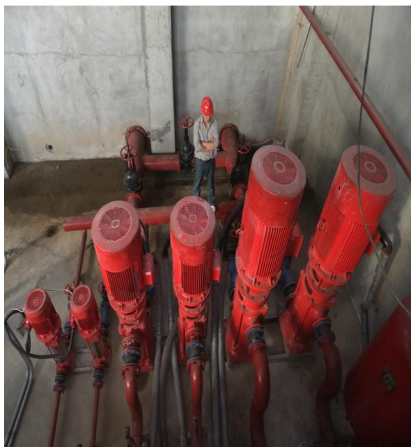
消防泵房系统
