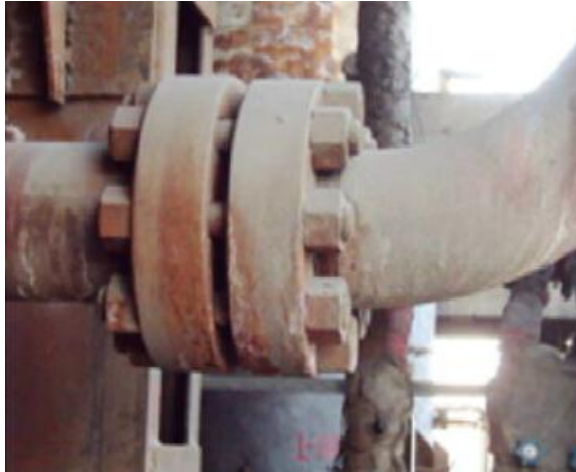
管道上的法兰连接
