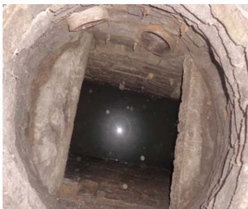
检查井修复前
