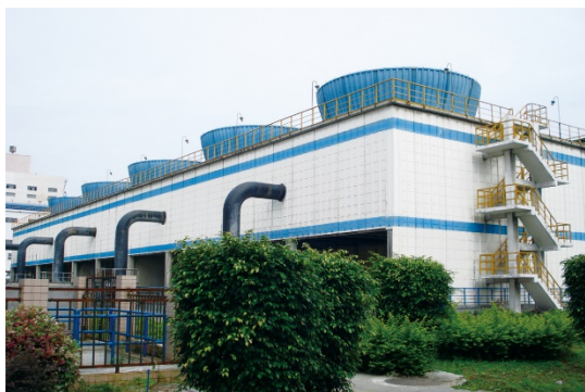
中国石油化工股份有限公司广州分公司(广东·广州) 10台 NH-4000 型冷却塔
