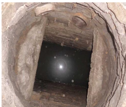
检查井修复前
