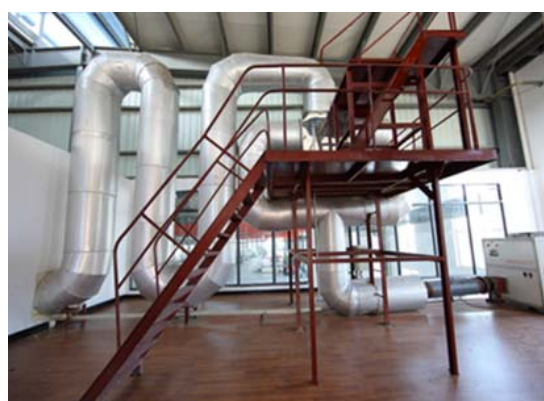
过滤吸收器滤毒检测系统
