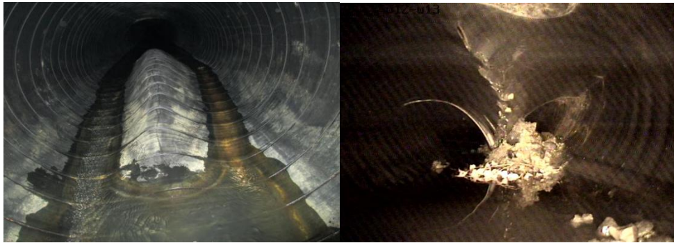
倒“V”字形变形、破裂 “V”字形变形、破裂
