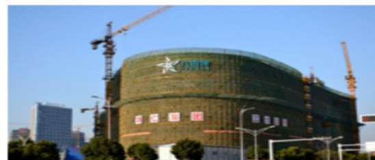
芜湖八佰伴生活广场配电工程
