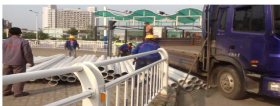
芜湖县政府大楼配电工程
