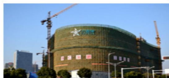
芜湖八佰伴生活广场配电工程
