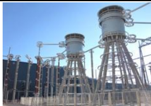
公司支柱复合绝缘子在全球首座特高压直流 \pm 800 kV 换流站-穗东换流站的应用情况
