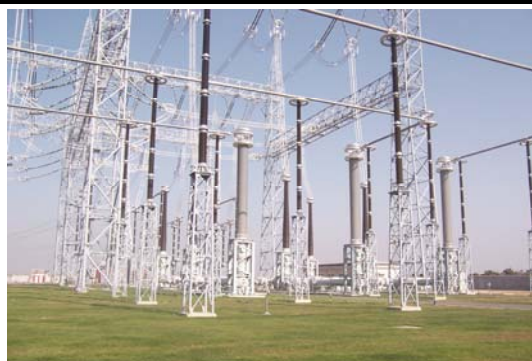
公司空心复合绝缘子在全球首座特高压交流 1,000kV 变电站-荆门变电站的应用情况
