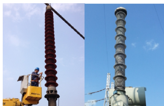
公司防闪络解决方案在换流站设备上的应用情况
