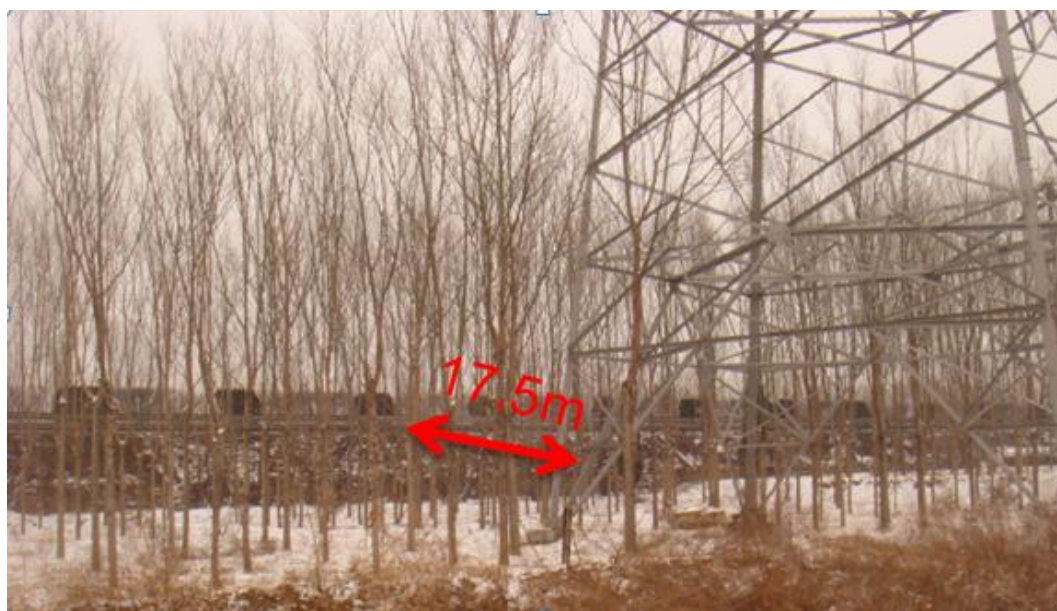
图 16-6 华德线 500kV 第 066 号高压线塔与京台高速位置示意图
