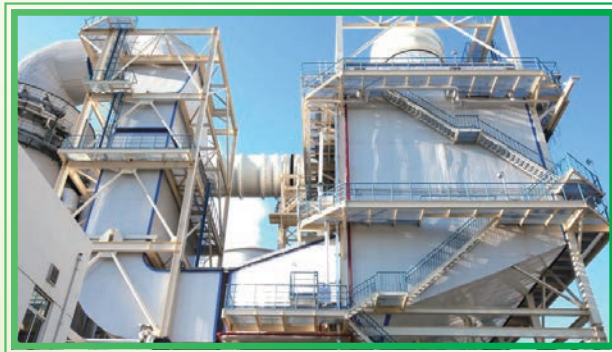
国华三河电厂“近零排放”湿式除尘器设备
