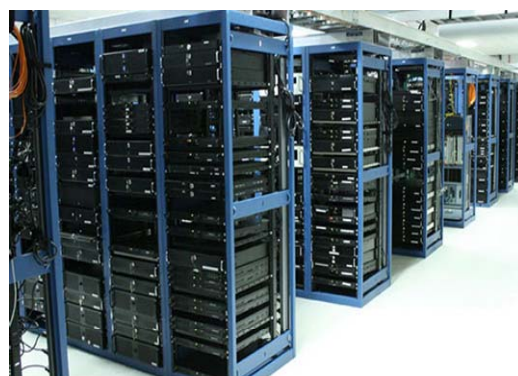
上海呼兰数据中心
