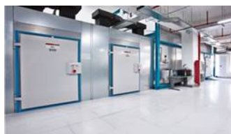
EMC实验室（外部）
