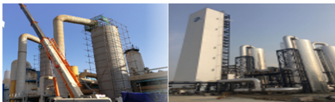
天安化工 5.2 万 Nm 3 /h 深冷空分装置
