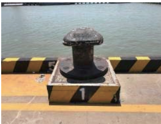
系纜柱 — 除銹刷新前
