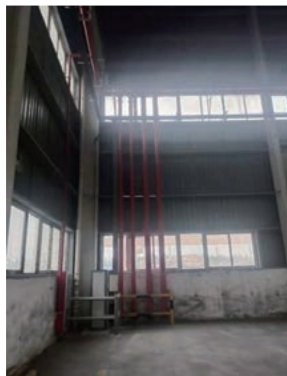
新消防系統 — 消防水龍管
