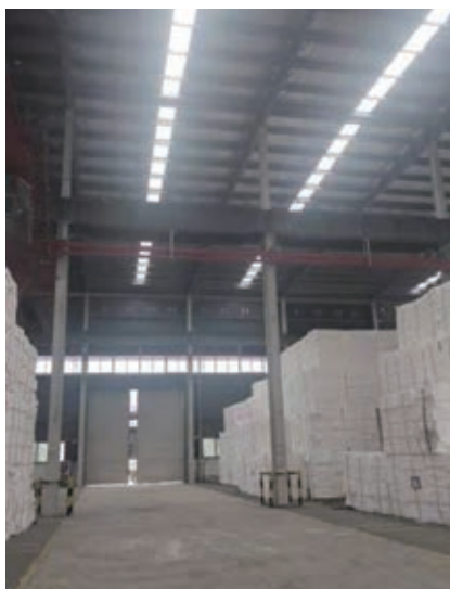
新消防系統 — 消防水龍管
