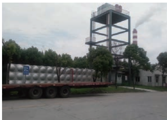
新消防系統 — 水箱及水泵
