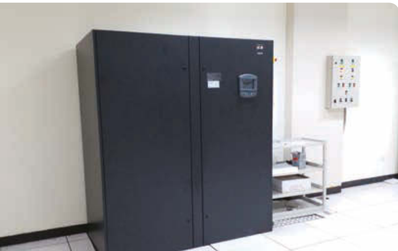
▲ 提升南丫發電廠新系統控制大樓內的空調系統，以進一步節省電力。
