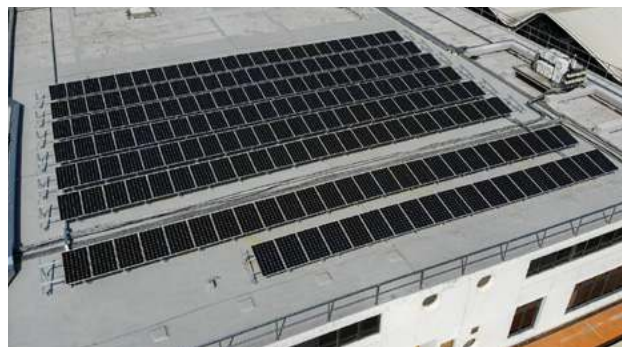
港鐵紅磡辦公大樓裝設的太陽能板
