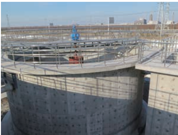
污泥沉澱系統
