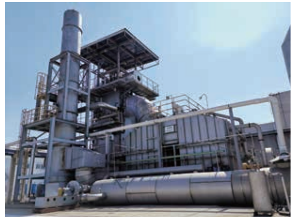
RTO(蓄熱式焚化爐)焚燒系統
