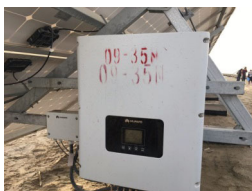
安裝於太陽能陣列上之逆變器
