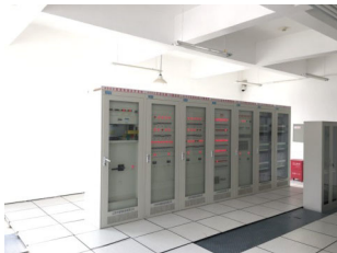
控制室之電腦化系統
