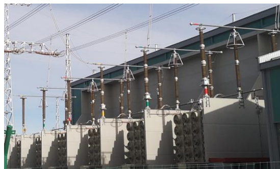
750kV 瓷外套避雷器伊克昭站
