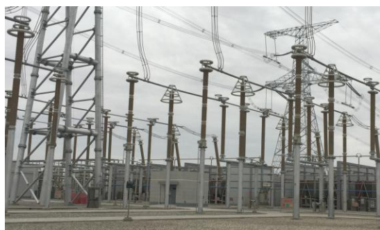
750kV 复合外套避雷器沙洲站
