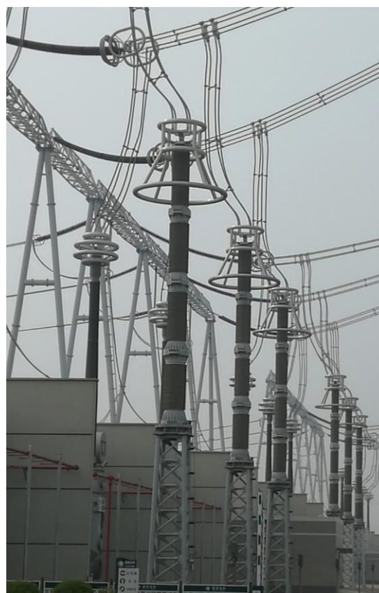
1000kV 复合外套避雷器潍坊站
