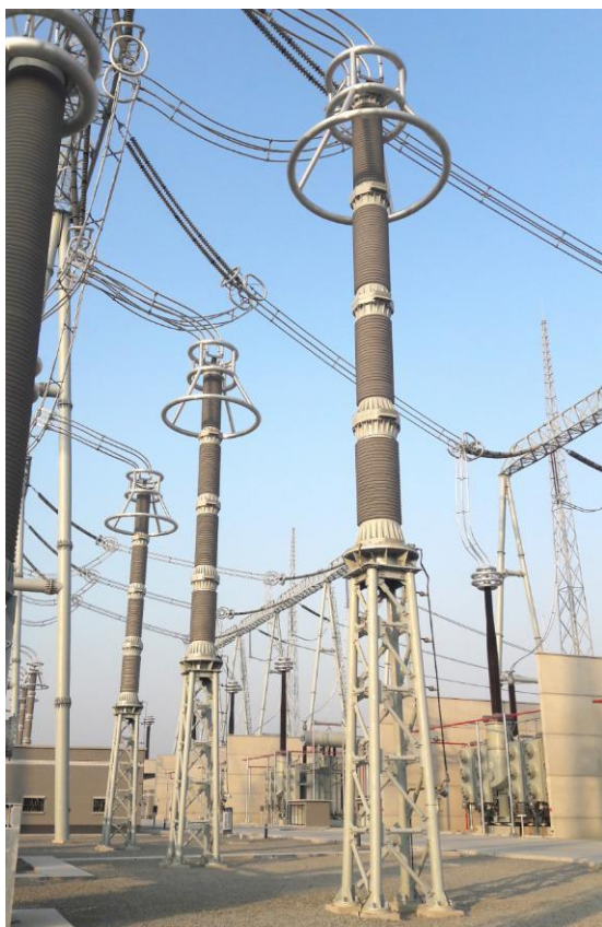
1000kV 复合外套避雷器临沂站
