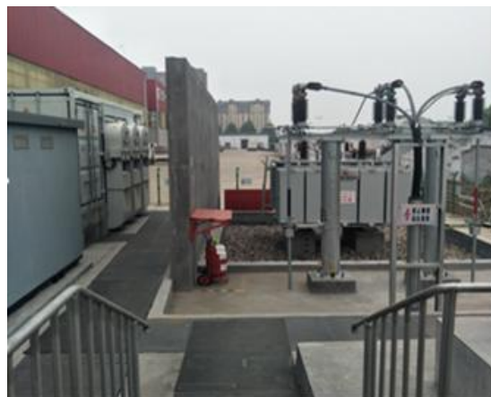
寿光农产品物流园30兆瓦分布式光伏发电项目
