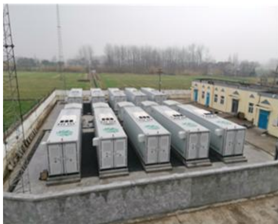
中石化曹庄变电所5MW-20MW储能项目
