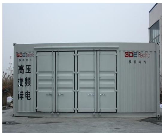
太仓武港码头高压岸电项目
