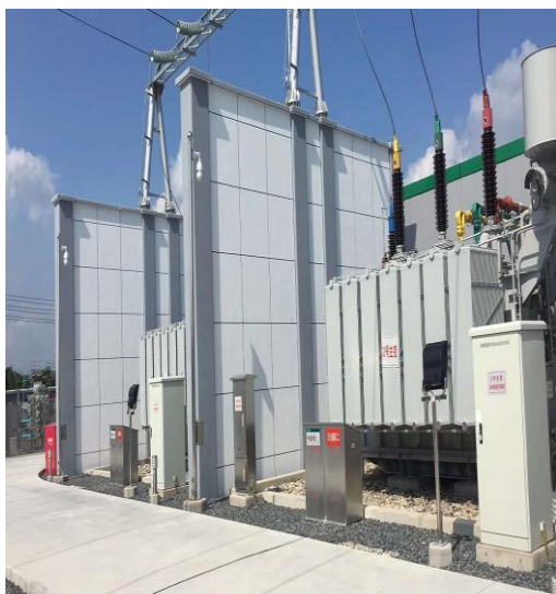
连云港盐西110kV输变电站工程
