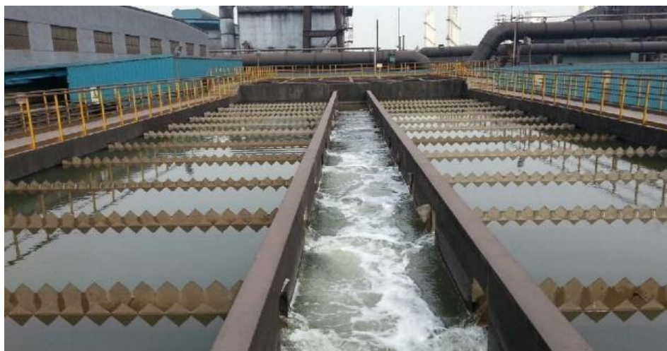
张家港联峰钢铁净水站项目
