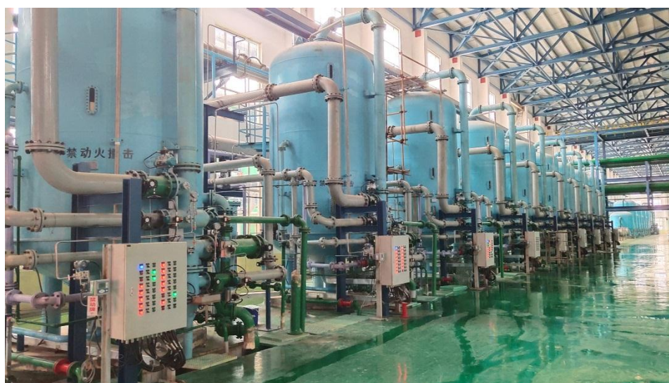
中科炼化凝结水项目
