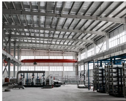
注：项目厂房内部图
