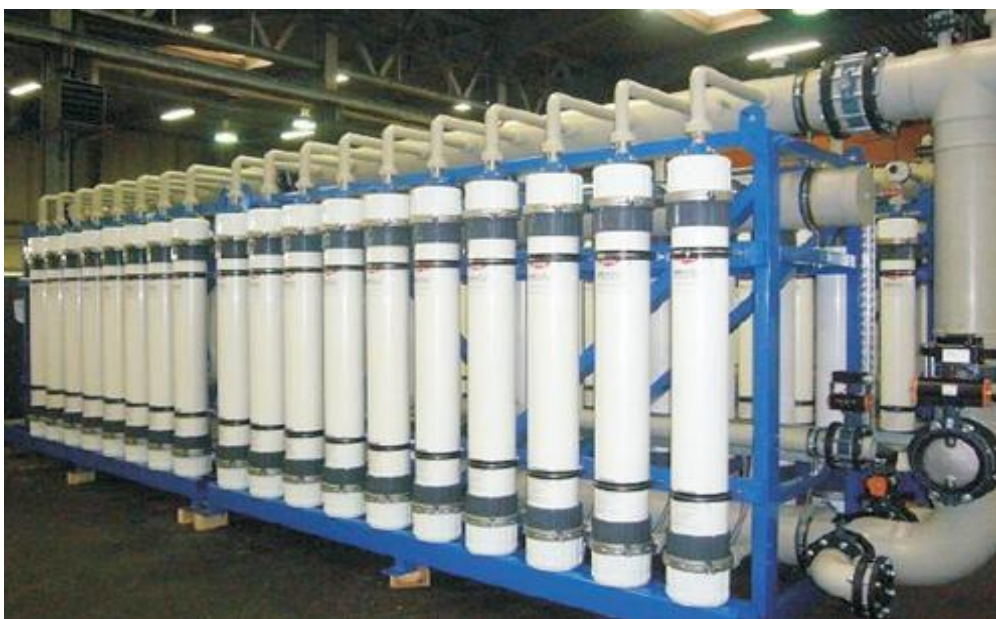
超滤设备实物图
