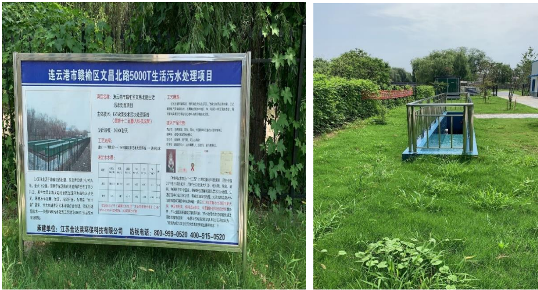
某居民小区内部金达莱污水处理设备
