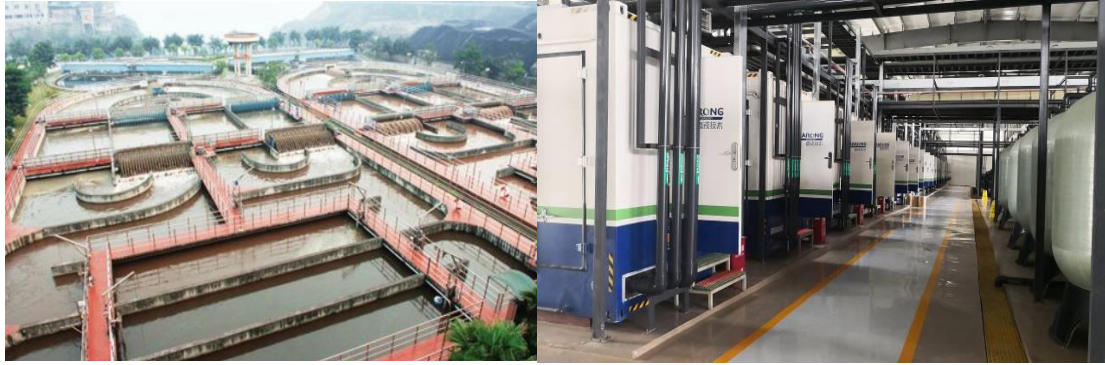
传统工程式废水处理项目
