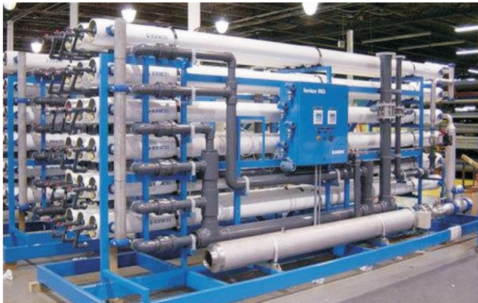
反渗透设备实物图
