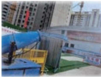
工地出入口霧炮機
