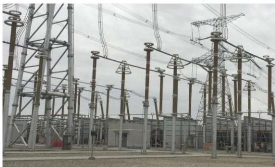
750kV 复合外套避雷器沙洲站
