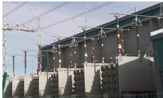
750kV 瓷外套避雷器伊克昭站
