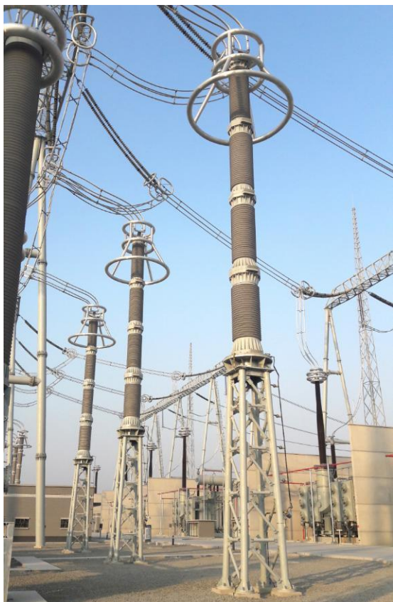
1000kV 复合外套避雷器临沂站
