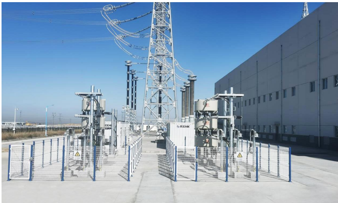
图9 公司为国家能源集团神华胜利电厂提供的 SSR-DS 成套装置
