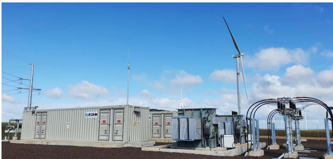
图 8 公司澳大利亚 Stockyard Hill Wind Farm 项目 STATCOM 成套装置现场
