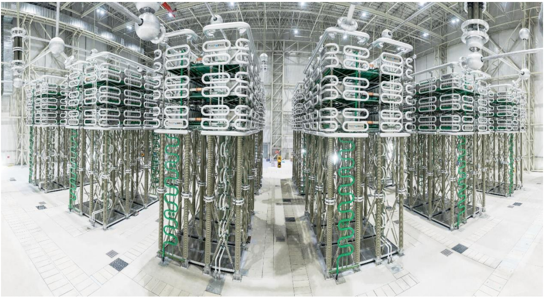
图 1 典型柔性直流换流阀（公司供货的±800kV 柔直换流阀乌东德柔直工程现场）
