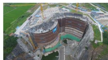
上海深坑酒店 扬尘在线监测
