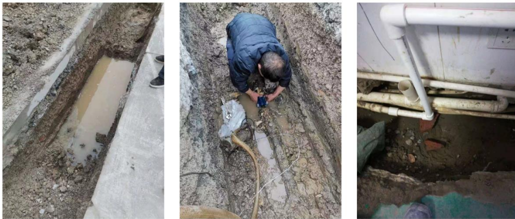
2020年11-12月公司厂区漏水及检修情况
