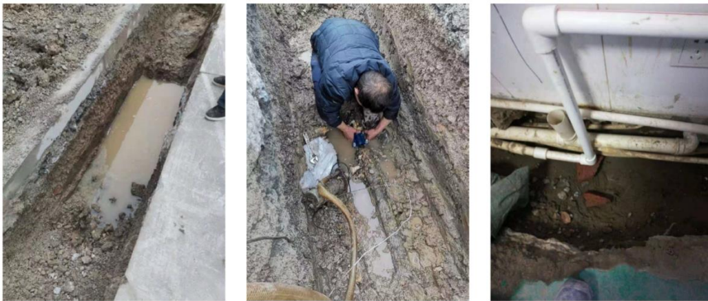
2020年11-12月公司厂区漏水及检修情况
