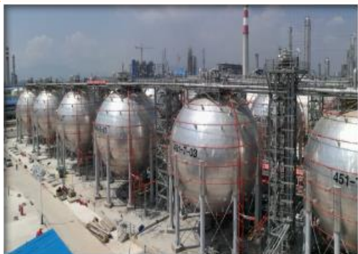
浙江石化 4000 万吨/年炼化项目
