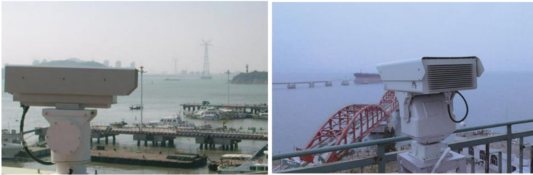
超长焦镜头应用示意：北京南水北调项目监控（左），南京长江大桥监控（右）
