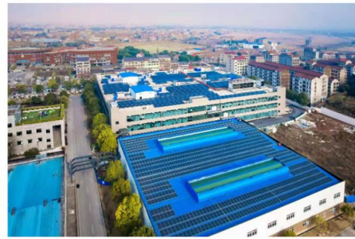
艾华集团微电网项目
