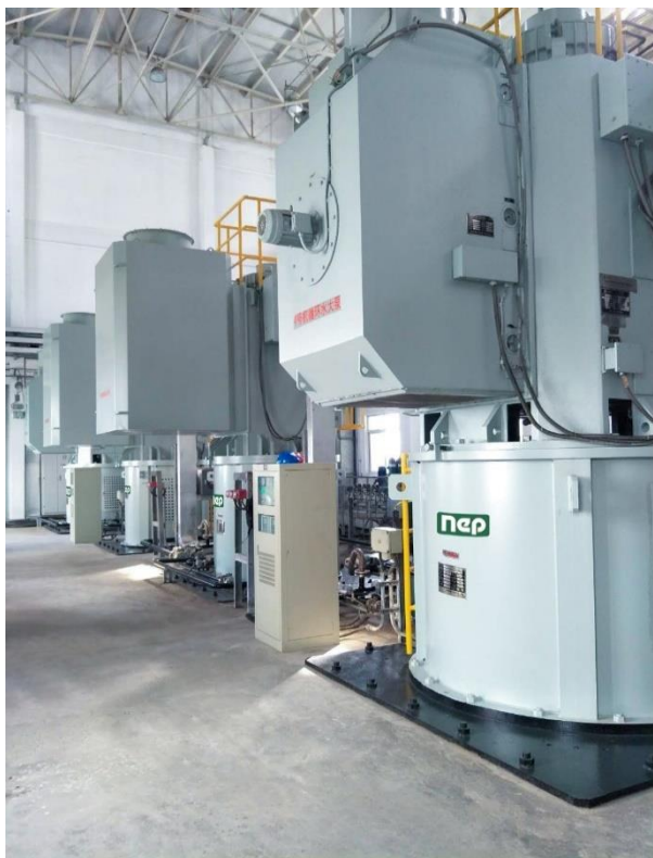
华能临港（天津）燃气热电项目立式斜流泵
