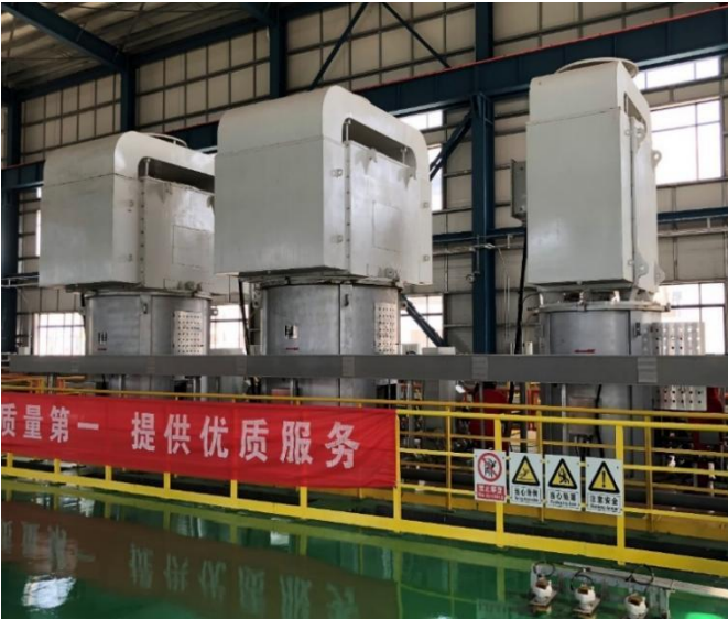
中石化天津 LNG 接收站项目立式海水泵
