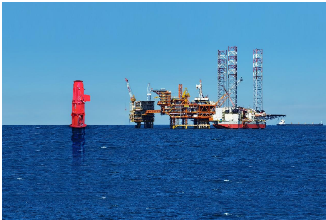
中海油渤中 19-4 油田开发项目海洋平台海水消防泵组
