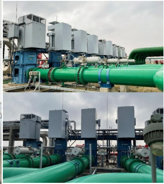
中海油上海 LNG 扩建项目立式海水泵
