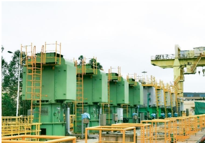
宝武集团湛江自备电厂立式海水泵
