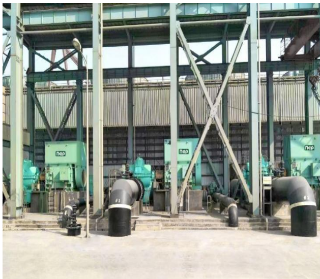
孟加拉沙吉巴扎电厂中开泵（1,800kW）
