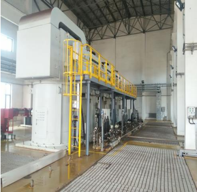
中石油唐山 LNG 接收站项目立式海水泵
