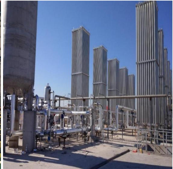
中石化胜利油建襄垣调峰站项目永磁低温泵
