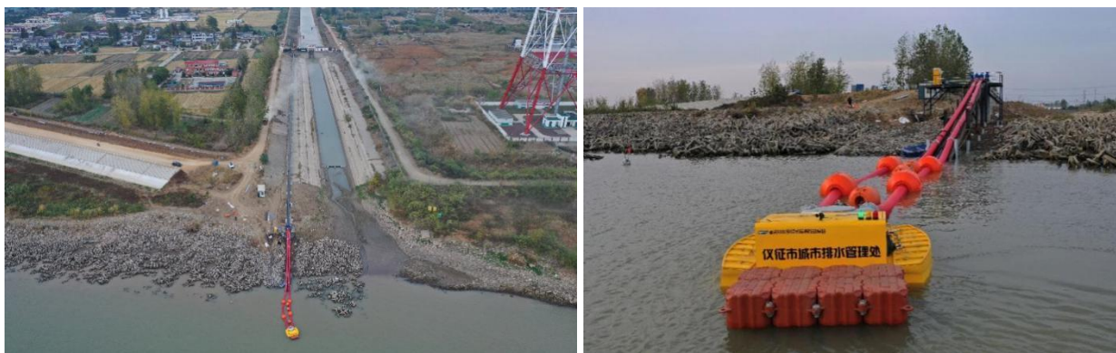
图示：2019-2021 年仪征胥浦河闸泵站改造期间，两辆迪沃 5000 型水陆两栖移动泵站
