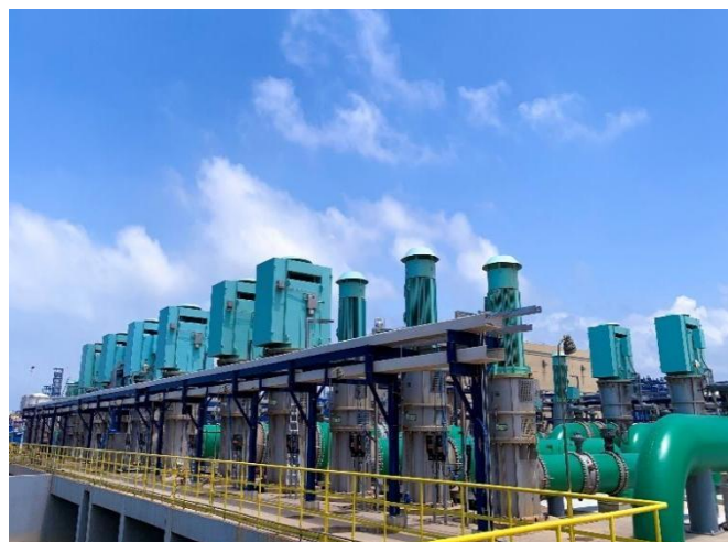
中石化海南炼化项目立式斜流泵
