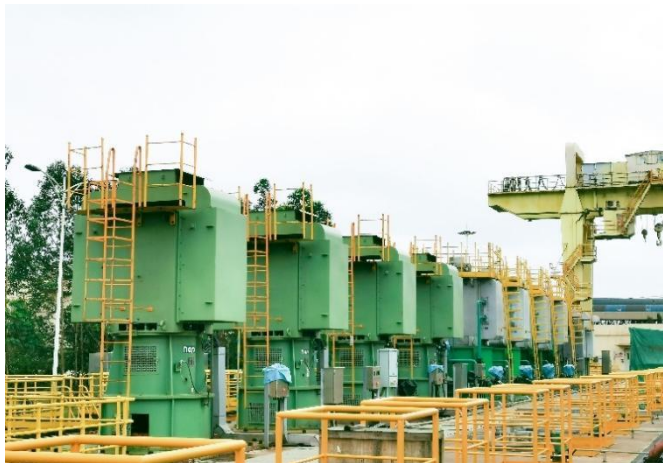
宝武集团湛江自备电厂立式海水泵
