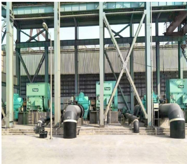
孟加拉沙吉巴扎电厂中开泵（1,800kW）
