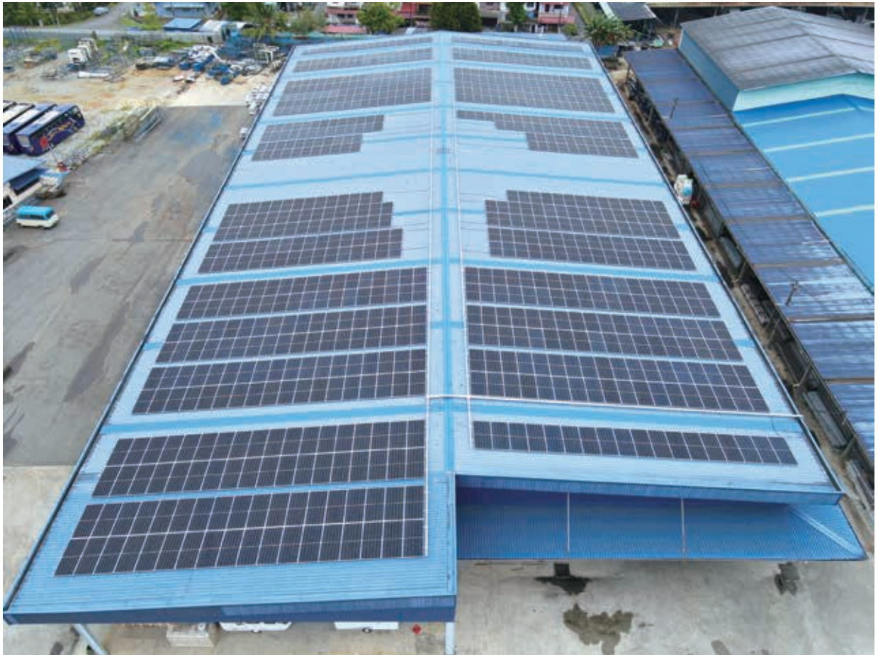
製造工場內光伏系統的照片
