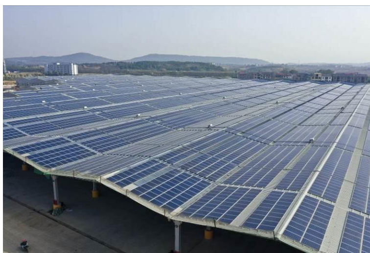
发行人江西丰城生产基地光伏厂房
