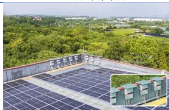
中国光伏整县推进项目
