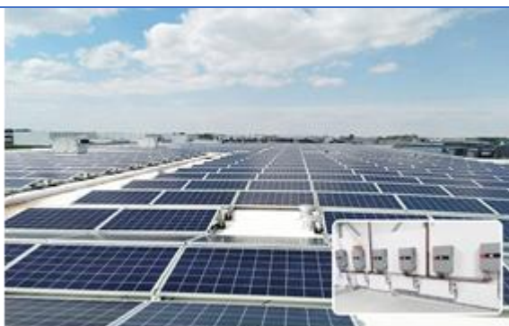
荷兰工商业光伏项目
