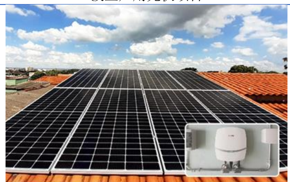
巴西户用光伏项目
