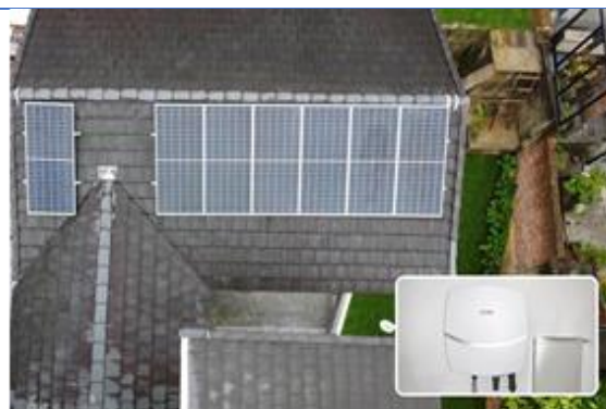
马来西亚户用光伏项目
